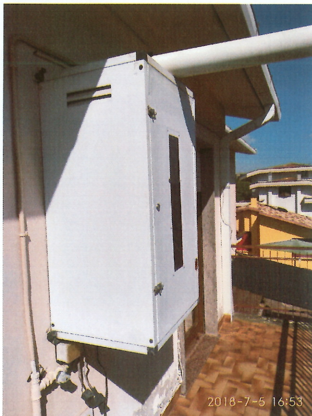
Caldaia a metano
